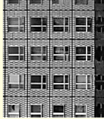
5 a Aussenwandplatte Keramik Galenusstraße 28 Panow
